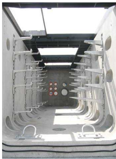
共同溝内部。 点検作業も 容易に行えます。
