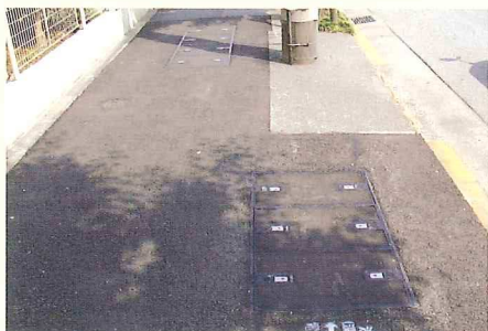
横断柵および通信接続柵
